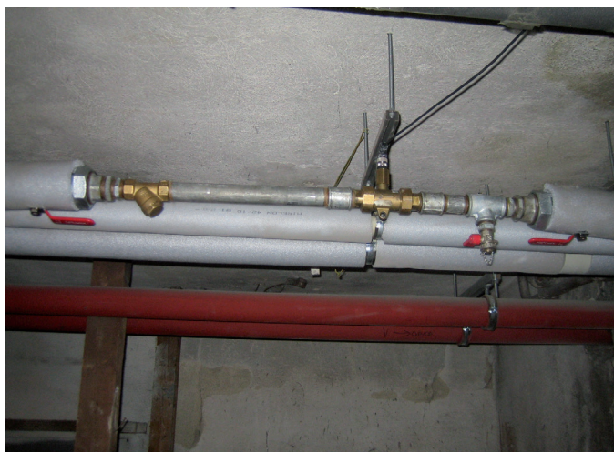
Obr. 2 Měření průtoku vody v bytovém domě v Brně průtokoměrem AHLBORN FVA915VTH25 DN 25
