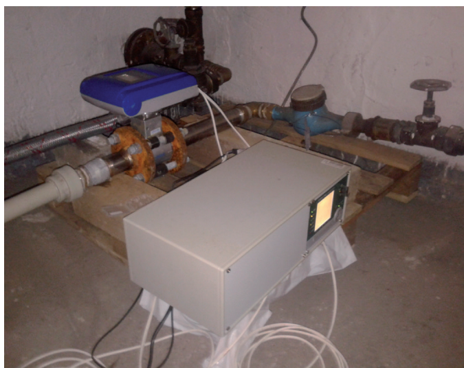
Obr. 1 Měření průtoku vody v bytovém domě v Českém Těšíně průtokoměrem OPTIFLUX 1000 s převodníkem IFC 100C DN 40 propojeným s datovou ústřednou AHLBORN ALMEMO A 5690-2 TS
