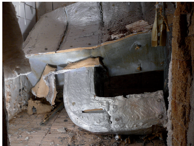
Obr. 5 Pád VZT potrubí při působení požáru dle normové teplotní křivky již po 20 minutách testu z důvodu zavěšení na nekvalitním typu závěsného zařízení
